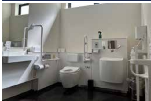
多機能トイレ Multifunctional toilet
