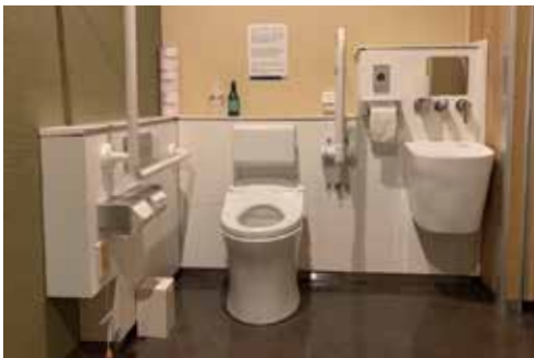
多機能トイレ Multifunctional toilet
