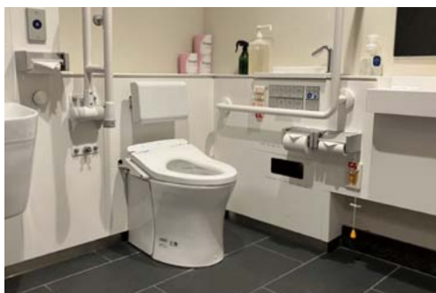
多機能トイレ Multifunctional toilet
